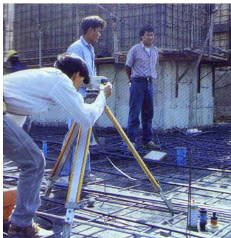
ข. แสดงการให้ค่าระดับพื้นที่ต่างๆ โดยใช้กล้องระดับ
