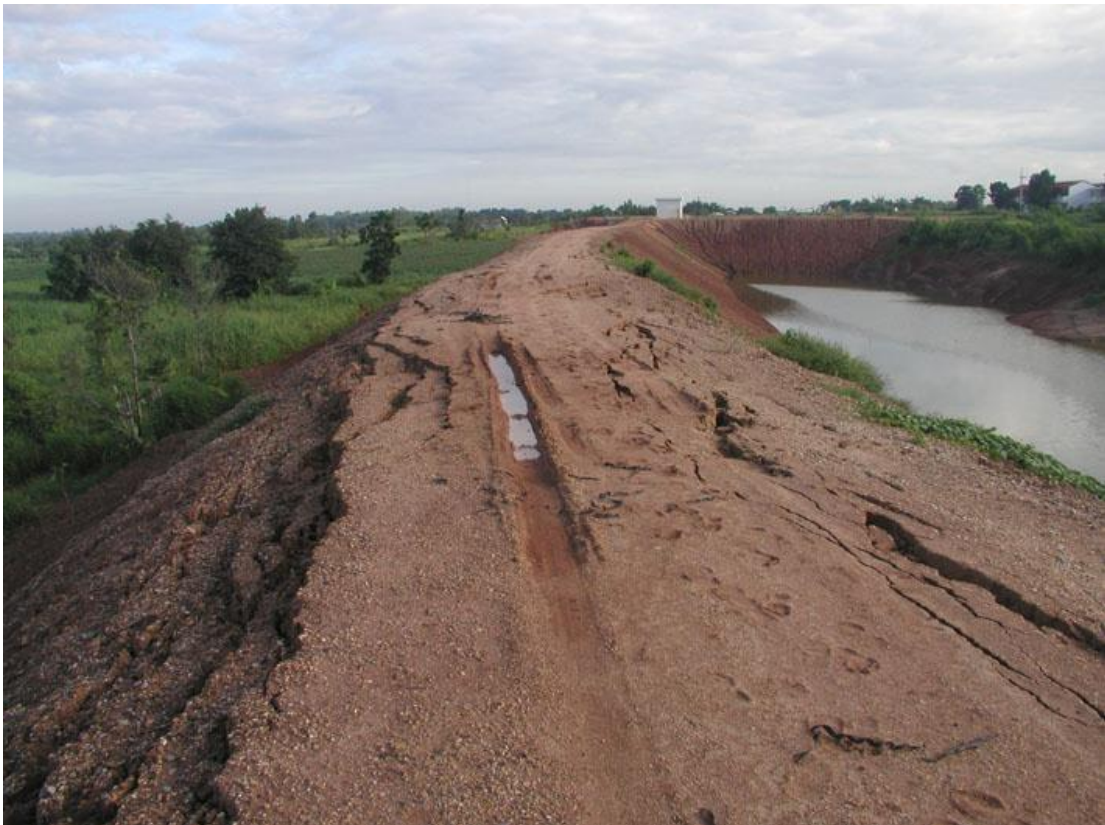
รูปที่ 6-12 คันดินมีเสถียรภาพลดลงเนื่องจากน้ำหนักของยานพาหนะที่เคลื่อนที่บนคันดิน
