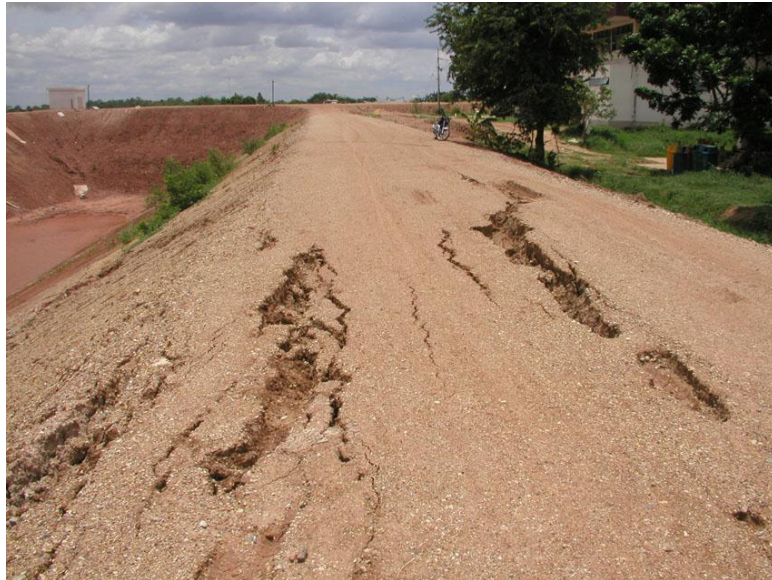
รูปที่ 5-26 รอยแยกเนื่องจากหน่วยแรงดึงในดินเหนียว
