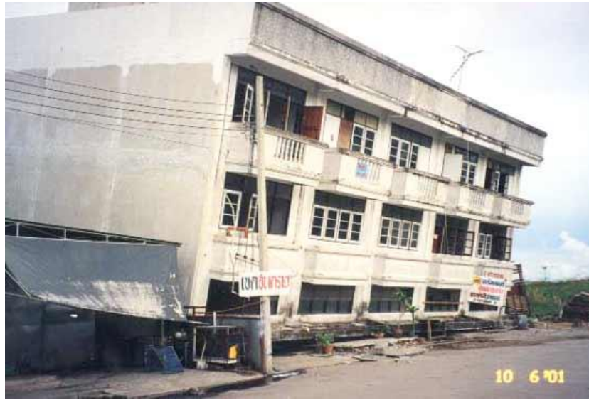
รูปที่ 1-2 อาคารที่เกิดการทรุดตัวจนใช้งานไม่ได้แต่โครงสร้างอาคารไม่เกิดการวิบัติ (ภาพจากเว็บไซต์ของ วิศวกรรมสถานแห่งประเทศไทย)
