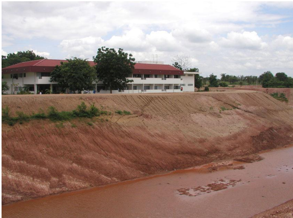
รูปที่ 6-10 ลักษณะชั้นดินอ่อนเอียงตัวแทรกอยู่ในดินเหนียวแข็งซึ่งเป็นสาเหตุให้คันดินวิบัติ
