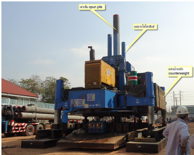
รูปที่ 4-30 เครื่องจักรติดตั้งเสาเข็มระบบกดที่มีแรงกดสูงสุด 420 ตัน
