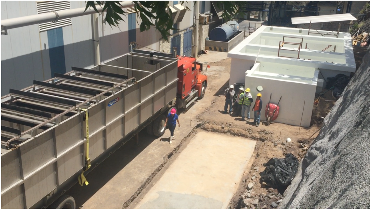
Figura de CAF para tratamiento primario listo para ser descargado de la cama de un tráiler.
