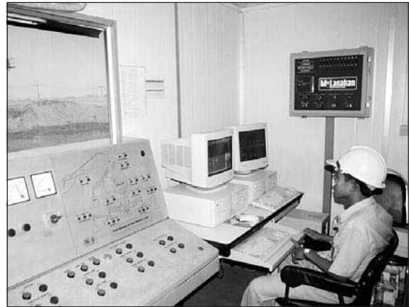
รูปที่ 10 ห้องควบคุมคุณภาพการผลิตและระบบควบคุม PLC
