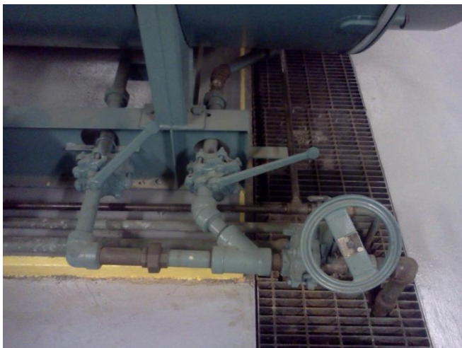
Purgas de fondo de calderas
