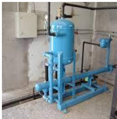
Sistema de Recuperación de calor en purgas
