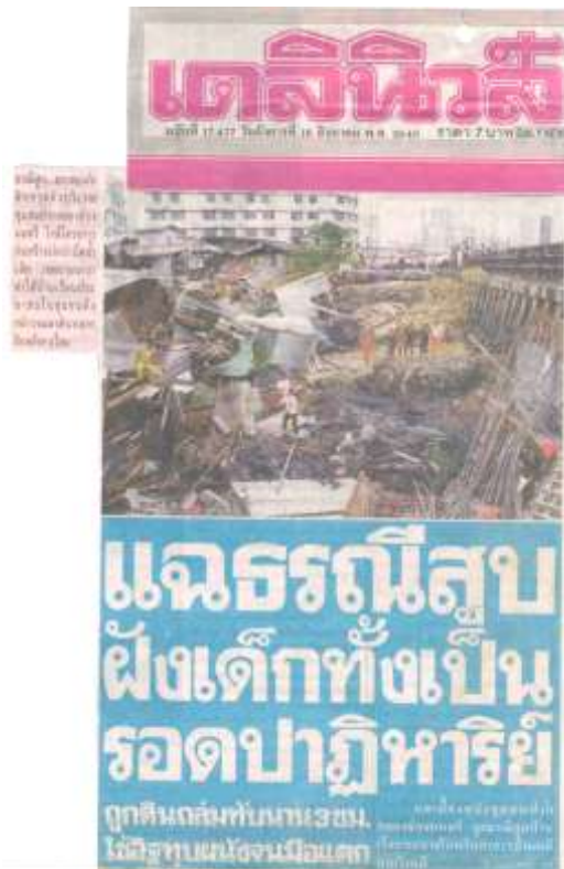
รูปที่ 1-11 ข่าวก่อนหน้าแรก การวิบัติของระบบกันดินสำหรับการก่อสร้างบ่อบำบัดน้ำเสียขนาดใหญ่ที่พังไว้ได้ดินเมื่อ 17 สิงหาคม 2540 (ข่าวจาก หนังสือพิมพ์เตลินิวส์)
