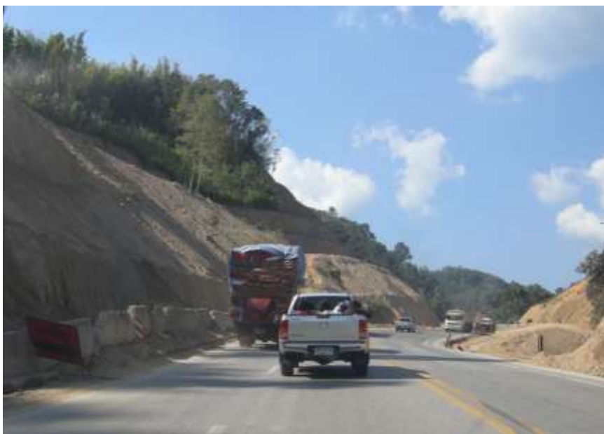
รูปที่ 1-8 ลาดดินขุดเชิงเขาติดกับทางหลวงช่วง แพร่-อุตรดิตถ์
