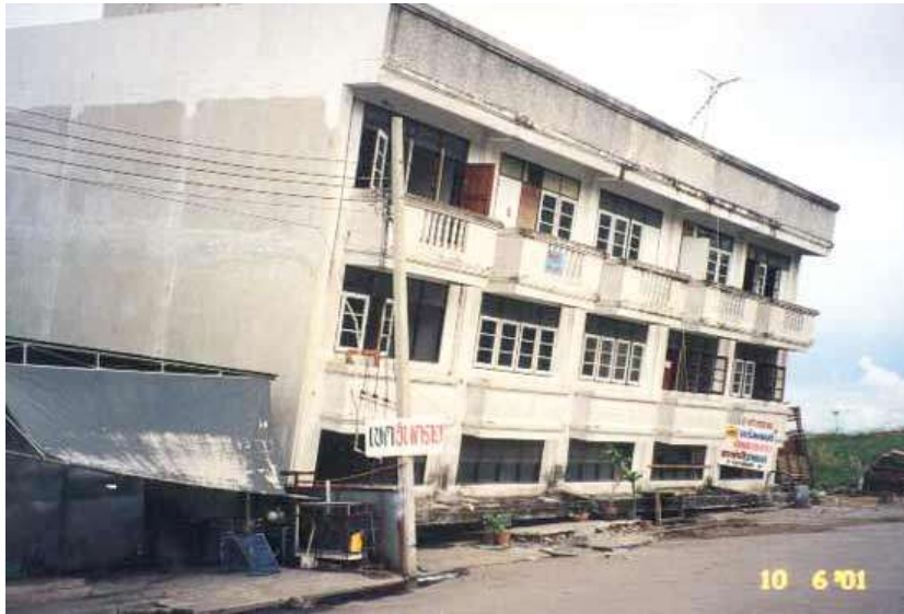
รูปที่ 1-3 อาคารที่เกิดการทรุดตัวจนใช้งานไม่ได้แต่โครงสร้างอาคารไม่เกิดการวิบัติ (ภาพจากเว็บไซต์ของ วิศวกรรมสถานแห่งประเทศไทยฯ)
