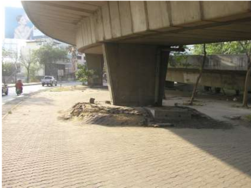
รูปที่ 1-6 การทรุดตัวที่แตกต่างกันระหว่างชั้นดินถมกับฐานรากของสะพานที่วางอยู่บนเสาเข็ม
